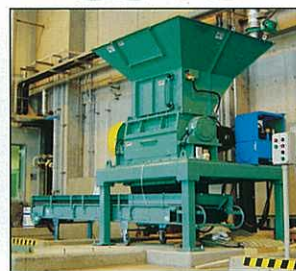
某市清掃センター/一般廃棄物破碎
